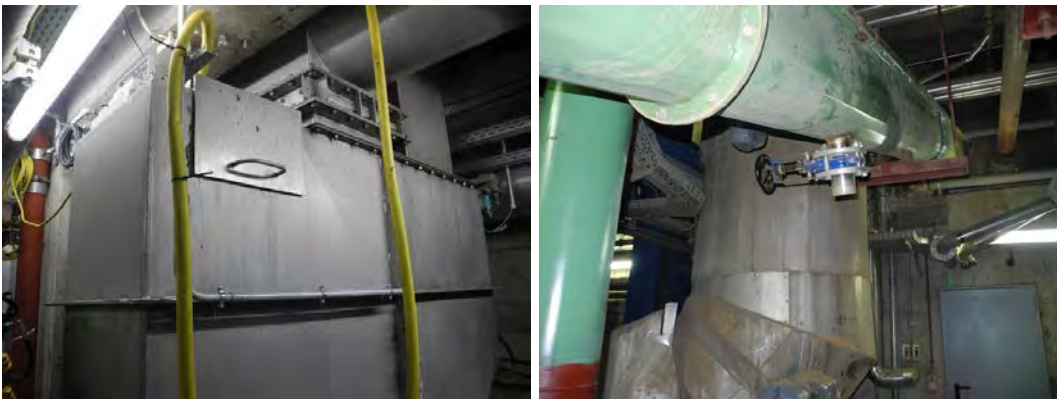
Probenahmestellen Rückstandsproben: Probenahmestelle 4 Klärschlamm eintrag vor Kessel (links); Probenahmestelle 5 Ascheaustrag (rechts).
