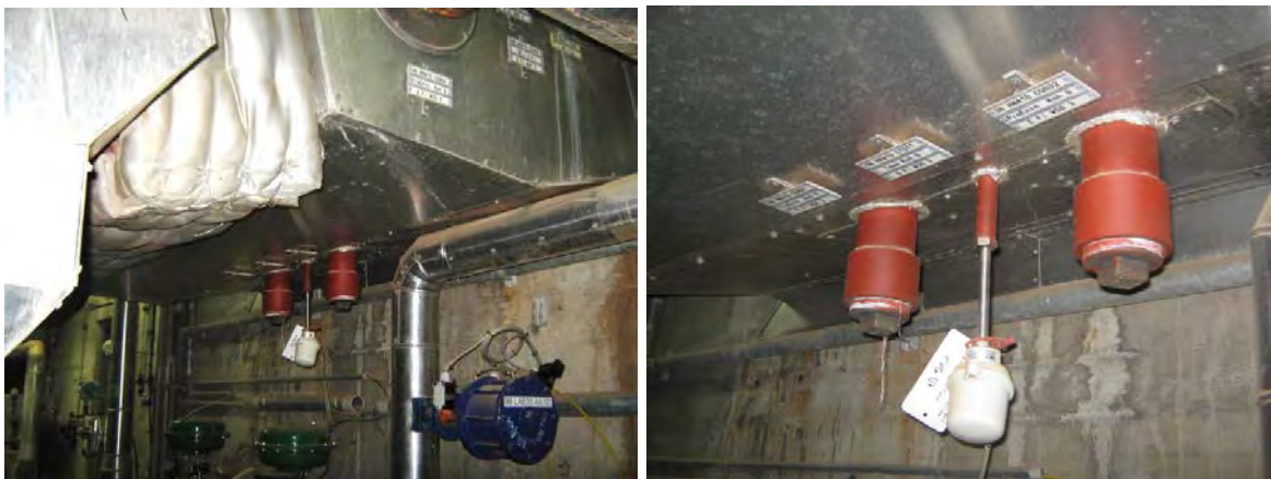
Messstelle Abgasbeprobung: Messstelle 1 nach Kessel
