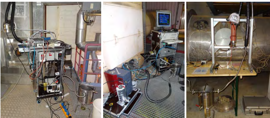
Messstellen Abgasbeprobung, Links: Messstelle nach Kessel, Mitte: nach Zyklon, Rechts: vor Kamin
